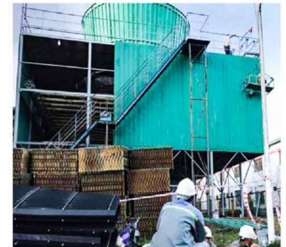
NHÀ MÁY NHÔM - ĐÀK NÔNG APF - 1500RT
